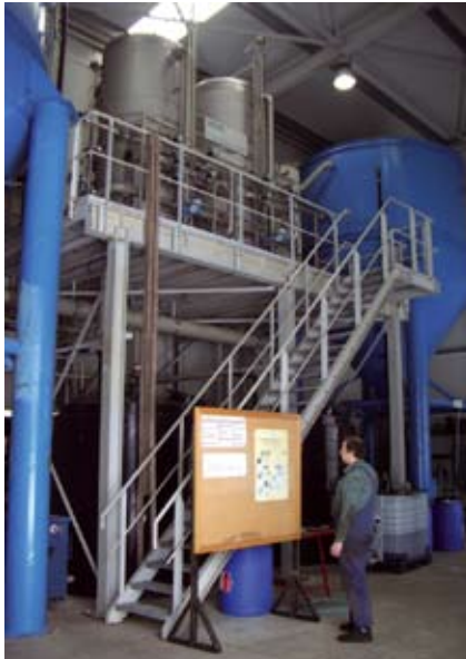
Anlage zur Wasseraufbereitung im Furnierwerk Winsen
