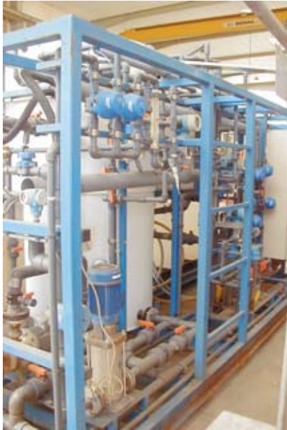
Membranbelebungsanlage zur Aufbereitung von Abwässern aus der Fruchtsaftherstellung
