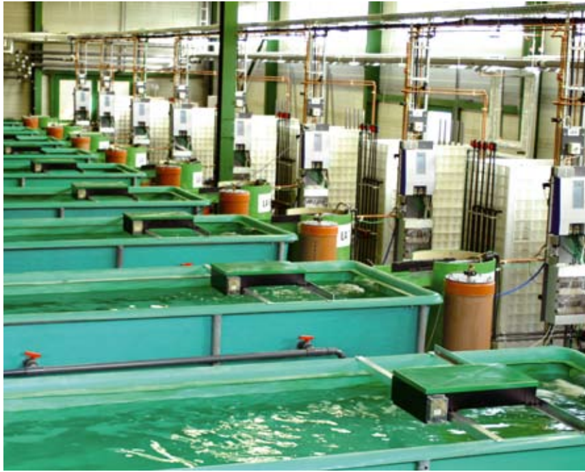
Langstrombecken-Anlagen für Setzlinge – rechts im Bild die Membranfilter
