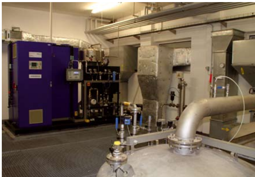
Ozonraum mit Steuereinheit, Ozongenerator und den beiden Reaktionsbehältern
