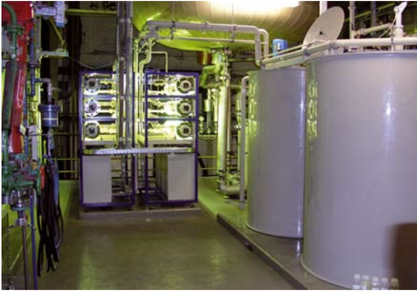
Die UV-Oxidationsanlage passt sich automatisch dem jeweiligen Volumenstrom des Abwassers an.
