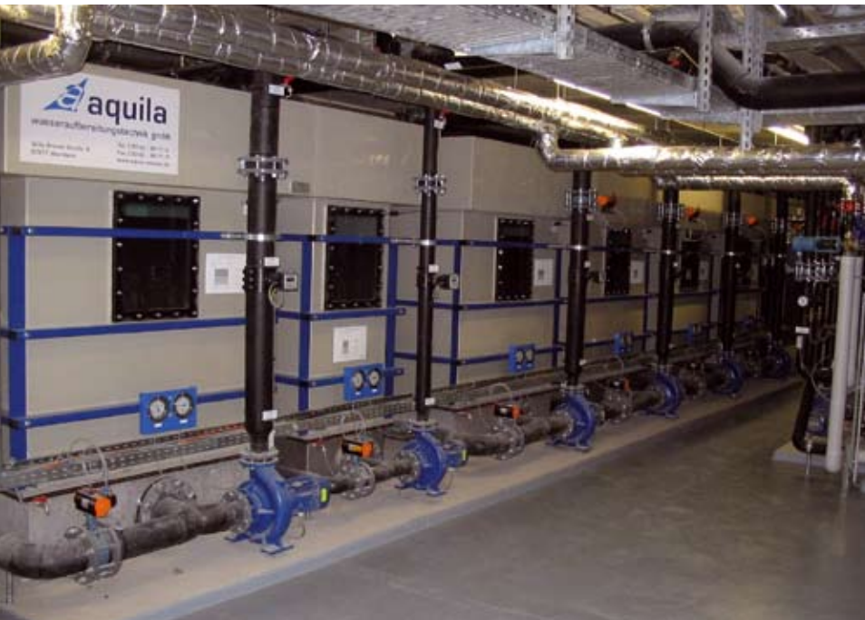
Das moderne Filtersystem im Nettebad in Osnabrück
