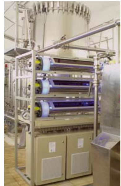
UV-Reaktor bei der Wirkstoffelimination aus dem Abwasser einer pharmazeutischen Mutterlauge
