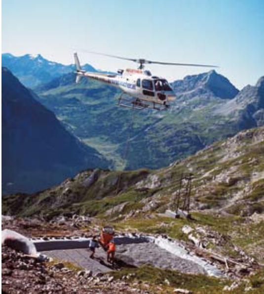
Bau der Abwasserreinigungsanlage Göppinger Hütte (2245 m. ü. NN. Vorarlberg, Österreich), Kooperationspartner OtterWasser GmbH
